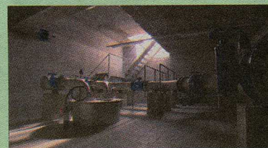
Captage de la Fin-de-la-Porta
